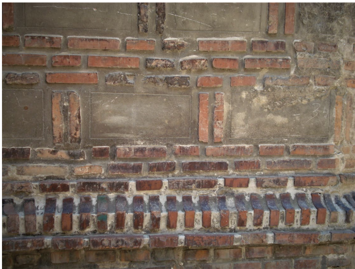
Biserica Curtea Veche din București (sec. XVI)– zidăria bisericii afectată de fumul lumânărilor înainte ca locul de aprindere al acestora să fi fost mutat
