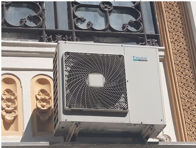
Biserica Sf. Spiridon Nou din București (sec.XVIII) – instalație de aer condiționat vizibilă pe parament (foto 2022)
