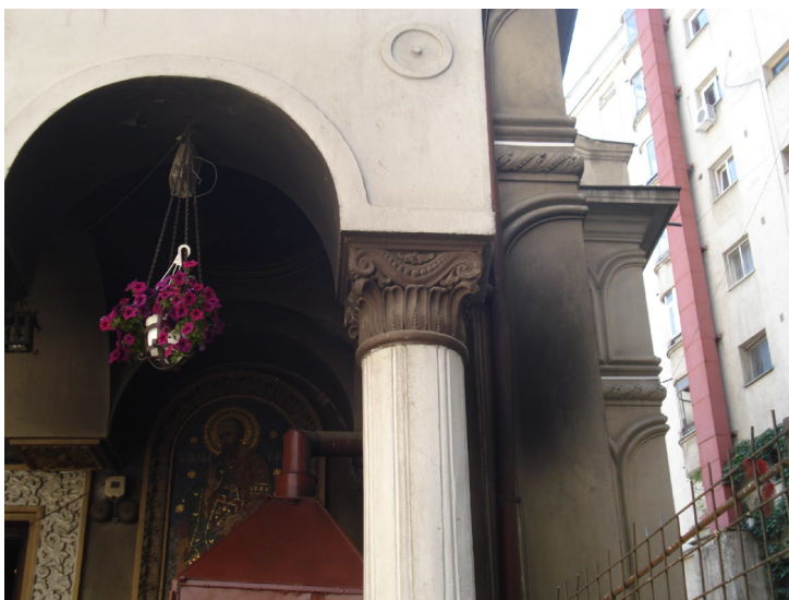
Biserica Sf. Ioan din București (sec. XVIII) – fațada de vest a bisericii afectată de fumul de lumânare
