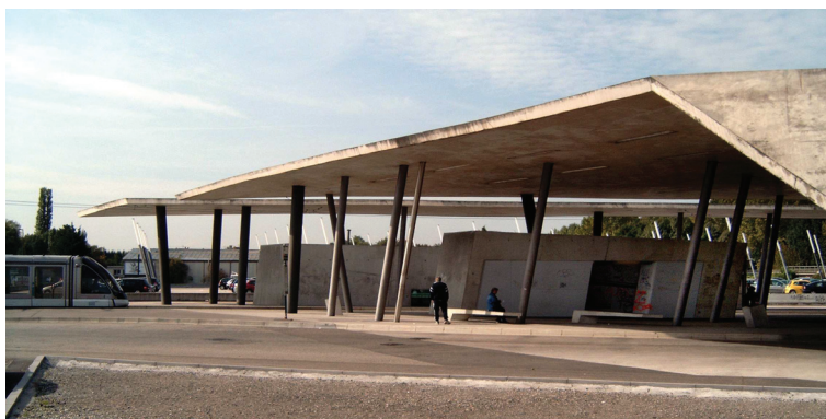
Fig.4.29 Zaha Hadid, Car Park and tram terminus Strasbourg, desprinderea acoperișului de planul orizontal; se observă stâlpii deformați parcă de această tensiune de desprindere
