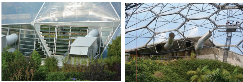
Fig. III.19-20 – Ventilare centralizată, automatizată exterior (stânga) și interior (dreapta), arhiva arh. Mihai Man
