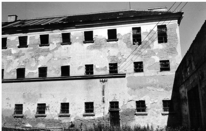
Fig. 74. Starea în care se afla clădirea închisorii de la Sighet în anul 1993, când a fost preluată de Fundația Academia Civică
