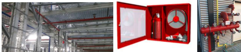
Fig. 9.13. – Rețea sprinklere, cutie pentru hidrant interior prevăzută cu un compartiment pentru un stingător și racorduri exterioare la instalația de stingere
