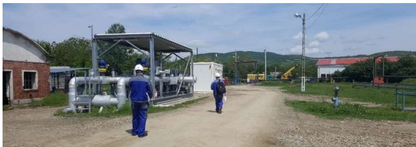
Fig. 8.24. Fotografie care prezintă noua ieșire din incinta a parcului de rezervoare rezultată în urma studiului privind influența curbelor de radiație termică asupra căilor de evacuare și intervenție din incintă
