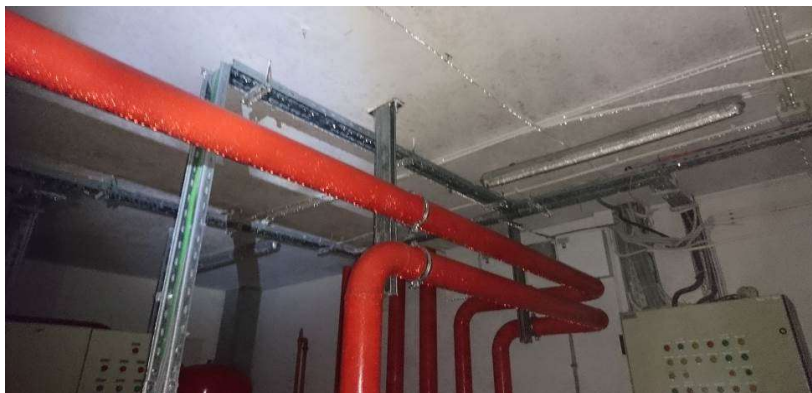
Fig. A2.1 Umiditate ridicată în subsol, deoarece sistemele de ventilație nu funcționează. Conductele și echipamentele electrice sunt deteriorate de umiditate
