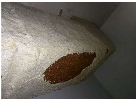
Fig. A2.2 Izolația tubulaturii împotriva incendiilor deteriorată de umiditate. Datorita oxidării tubulaturii metalice și a umezelii izolația s-a desprins de pe elementele de ventilație
