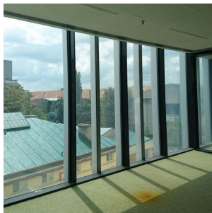
Fig. A2.6. Condensarea din țevi a afectat mocheta de sub capătul de sprinkler fără protecție
