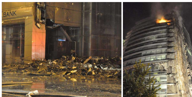
Fig. 5.18. Stânga - Resturile de la panourile de fațadă căzute în urma incendiului. Dreapta – Zone cu panouri desprinse de la fațadă 106
